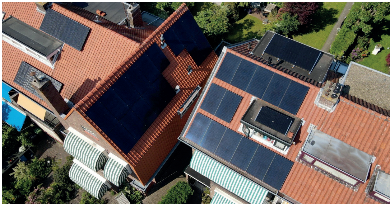
PV-panels Damsigt (bron: gemeente Leidschendam-Voorburg)
